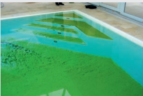
Schwimmbad mit starkem Algenbefall
